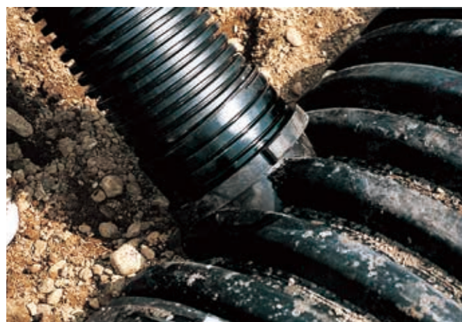
ゴム支管接続部
