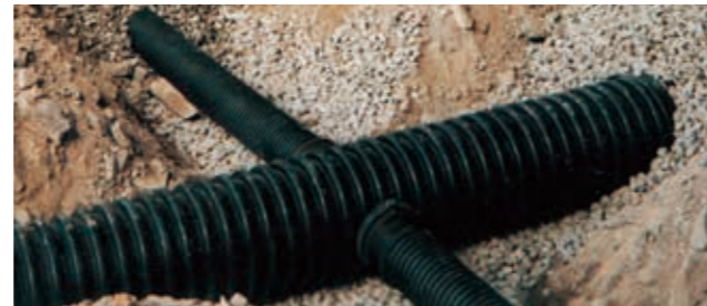
トンネルセンタードレン
